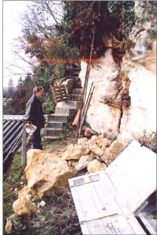
Fig. 47 : Chute de 2 m 3 de blocs au lieu-dit Jean Got Chibau (27 février 2006). A noter la présence d'une écaille instable à l'arrière plan (désolidarisée du massif) [Source : Bureau des Carrières de Gironde]
