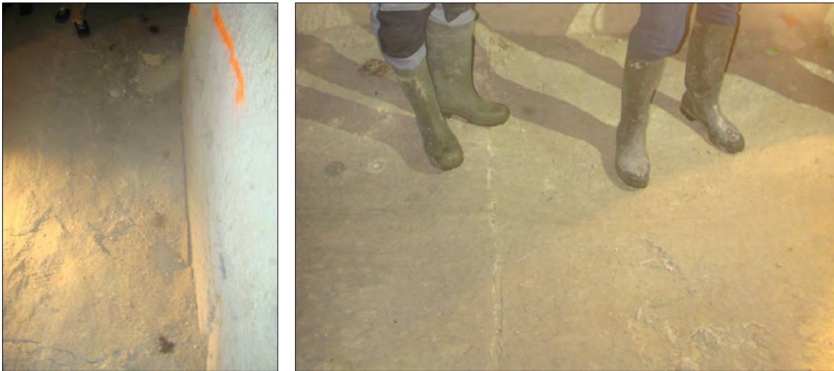
Fig. 40 : Fissuration des remblais, en pied de pilier (à gauche) et entre 2 piliers (à droite), dans la carrière du Château (Niveau -3) [Source : Ginger CEBTP]
