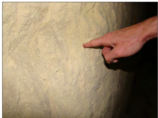
Fig. 41 : Perte de cohésion des calcaires sur la surface d'un pilier dans la carrière de Brun (Niveau -3) [Source : Ginger CEBTP]
