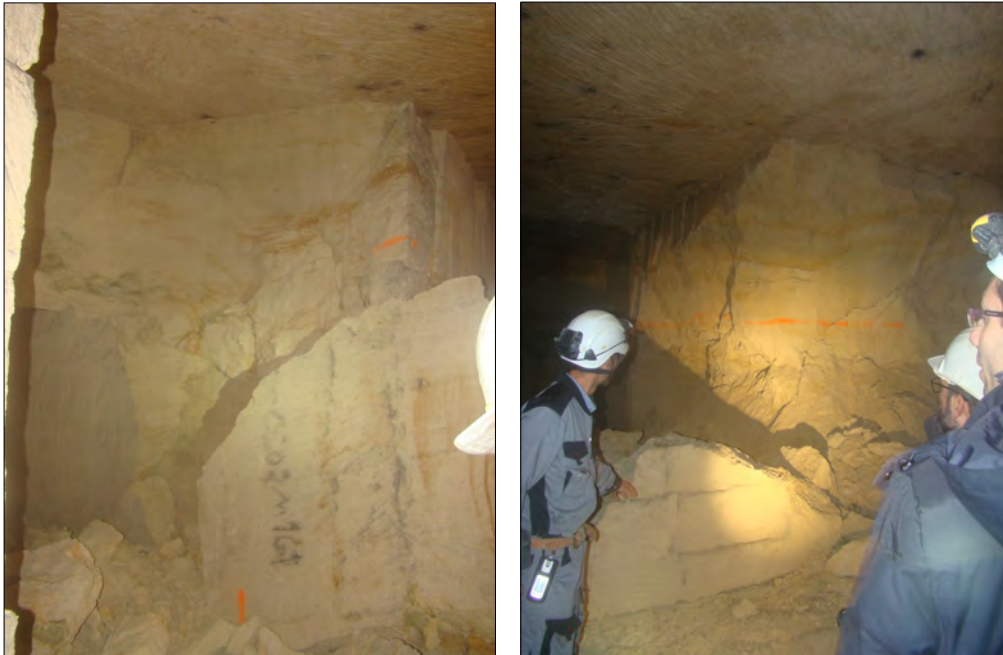
Fig. 38 : Rupture d'angles de piliers dans la carrière du Château (Niveau -3) [Source : Ginger CEBTP]
