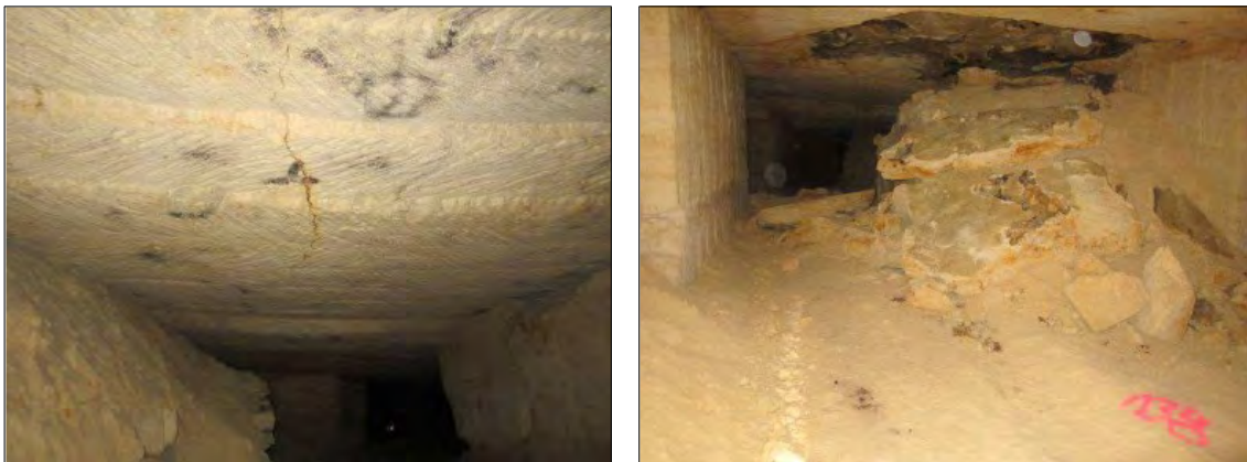
Fig. 34 : Fissuration de la dalle de ciel (à gauche) et effondrement de la dalle (à droite) dans le niveau -2 de la carrière « Le Basque Brun » [Source : Antea Group]
