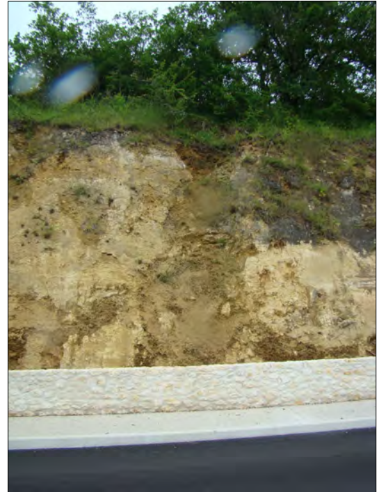
Fig. 48 : Glissement dans le talus en bordure de la rue du Bourg [Source : Ginger CEBTP]
