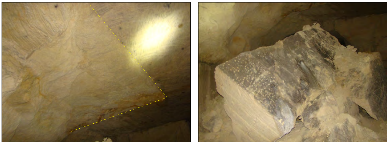
Fig. 39 : Pilier effondré dans la carrière du Château (Niveau -3) [Source : Ginger CEBTP]
