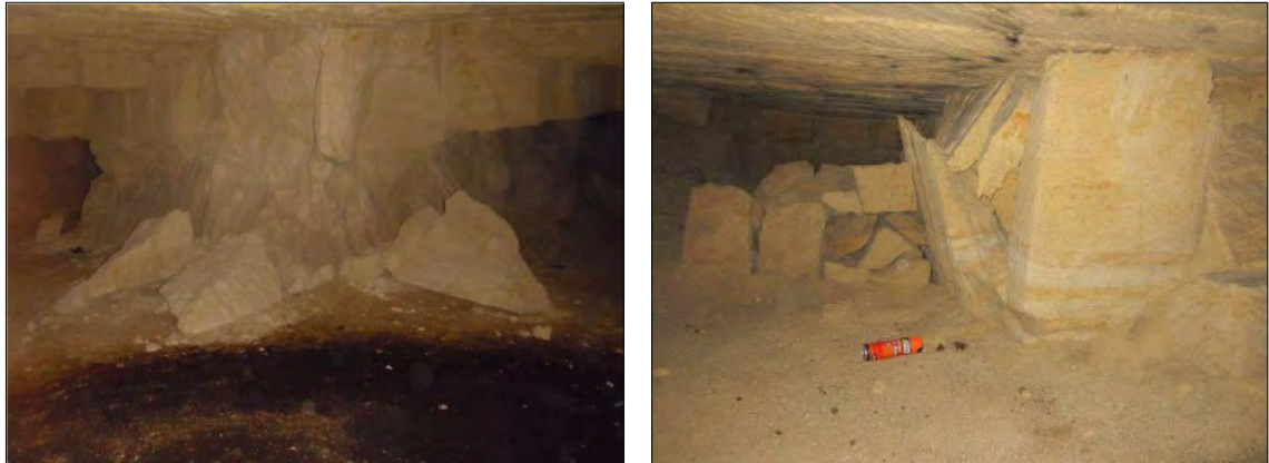
Fig. 35 : Fissuration d'un pilier « en diabolo » (à gauche) et pilier ruiné (à droite) dans les carrières de LATRESNE [Source : Antea Group]
